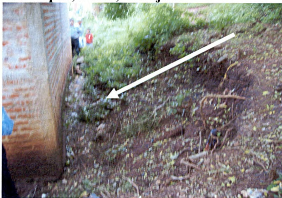
Deformación de vivienda por deslizamiento.
