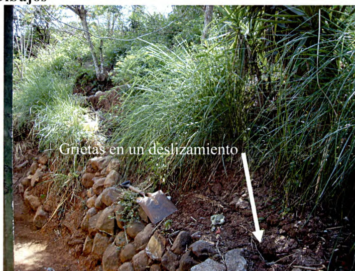
Fotografía que muestra un deslizamiento, con algunas obras de mitigación en mal estado.
